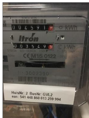
Elektriciteit meter-nacht tweevoudige
